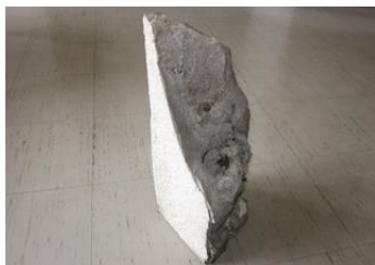
落下した学校外壁（池澤氏提供資料）
